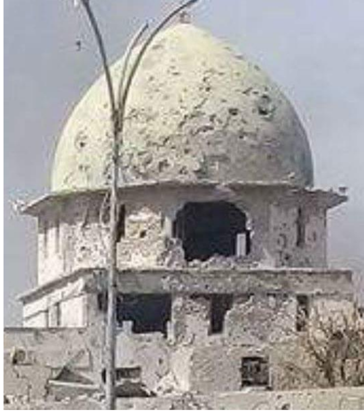
الصورة (١١) الأضرار التي لحقت بالقبة ورفقتها
