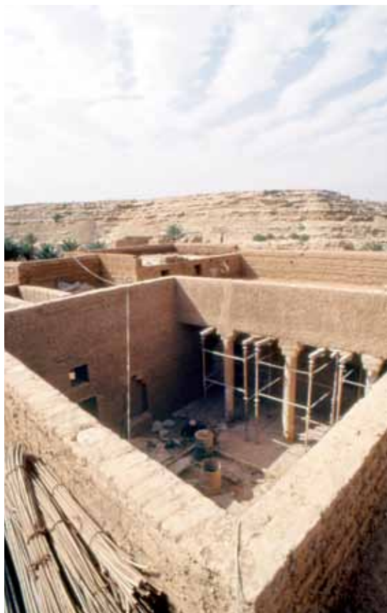
الحائط الجديد وقد أعيد بناؤه: منظر فوق الحوش يبين الجدران المبنية جديدة، وجاهزة للطلاء.
