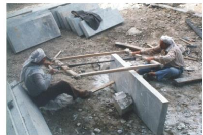
شكل رقم (16): الطريقة التقليدية في تقطيع المرمر الموصلية والمستخدم في الحالة الدراسة (المصدر: الباحث).
